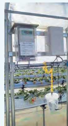
コントロールは制御盤で行い、発生装置と暖房機をケーブルで接続し連動させている。
