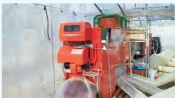
タンセラで発生させた炭酸ガスを暖房機の送風機能を使い、ダクトでハウス全体に供給する。
