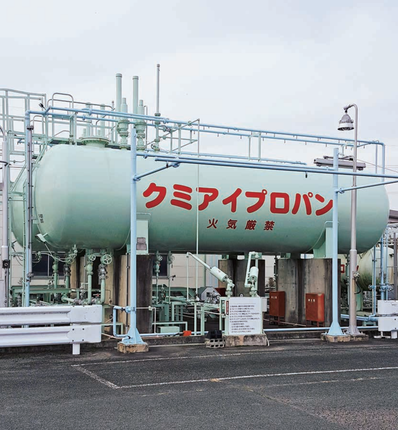
岩手クミアイプロパンセンター LPガス貯蔵タンク
