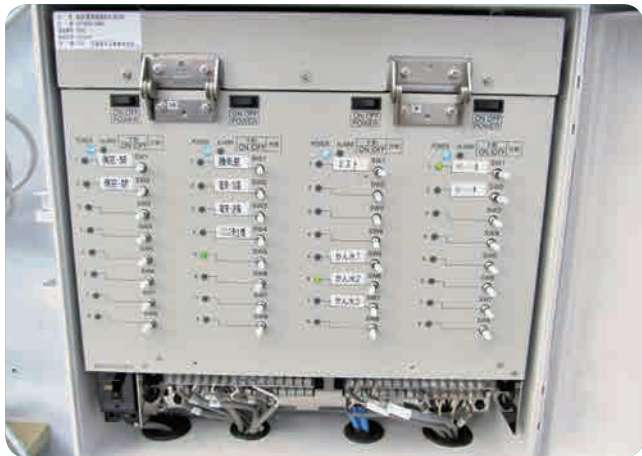
制御盤(農業研究センター提供)
